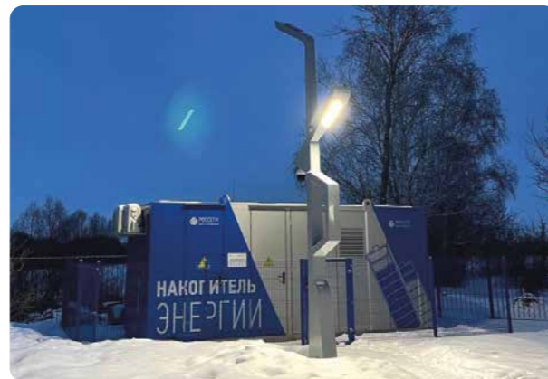
Система накопления электроэнергии
