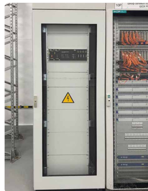
Внешний вид панели, установленной на ПС 110 кВ «Спутник».
